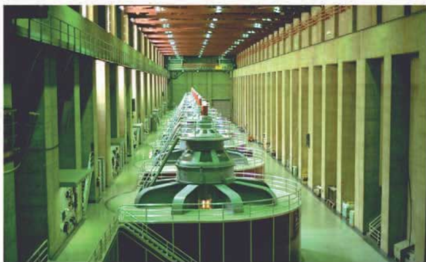
图20.5-6 现代水力发电厂中的发电机组
