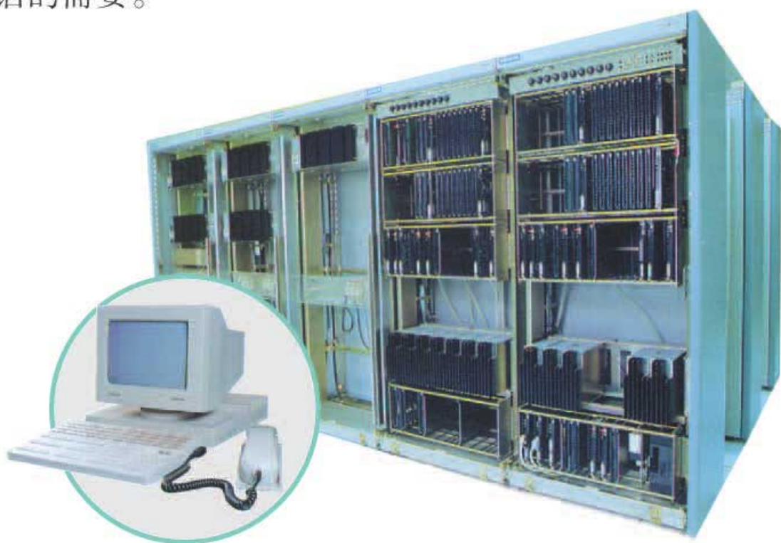
图 21.1-5 程控电话交换机和操作台
