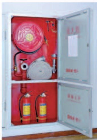
图7-10 建筑物内的消防设施
