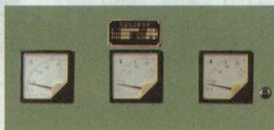
乙 配电板的正面
