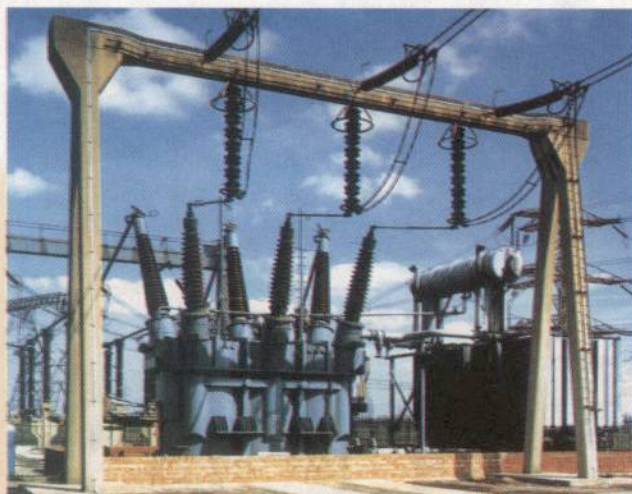
甲 变电站的大型变压器
